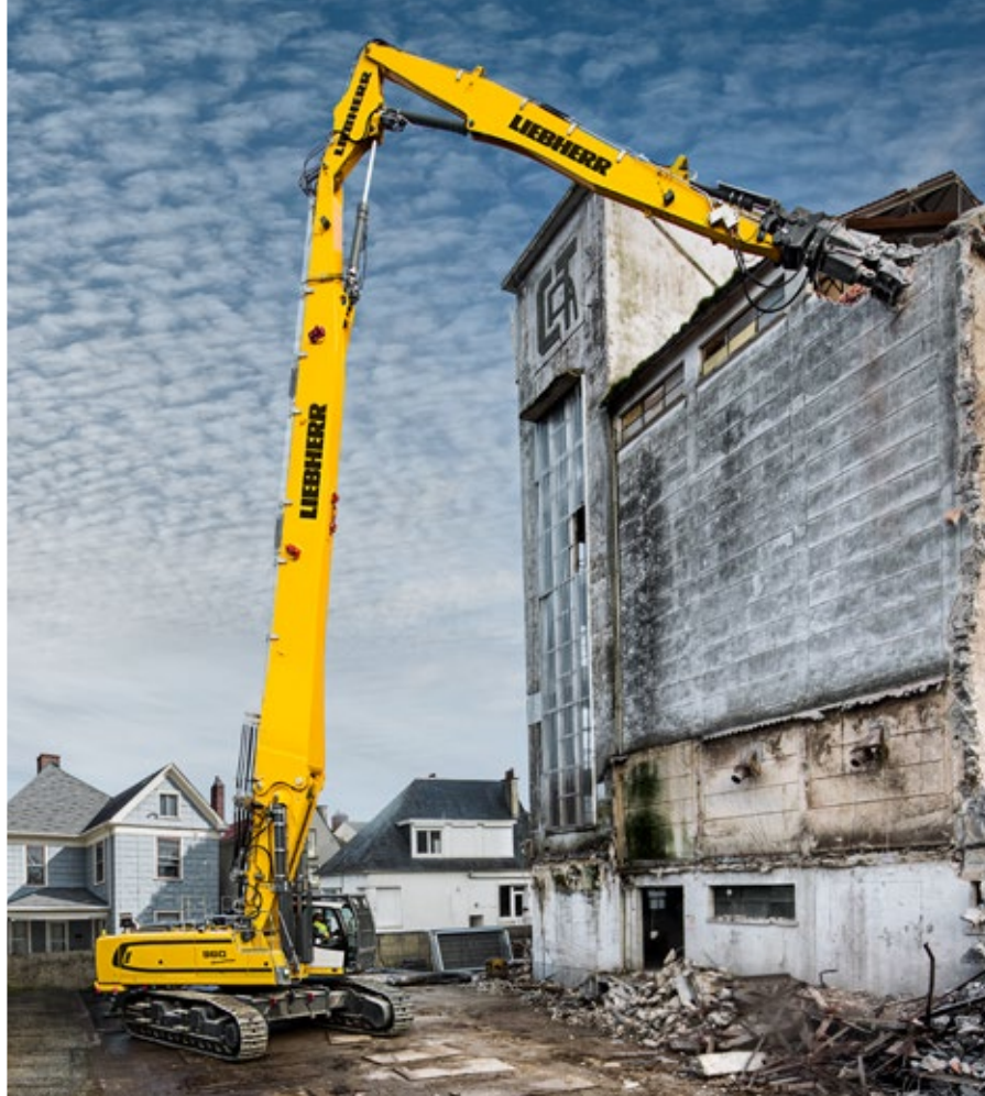
L'escavatore cingolato R 960 durante la demolizione di un silo a Frévent (Francia)
