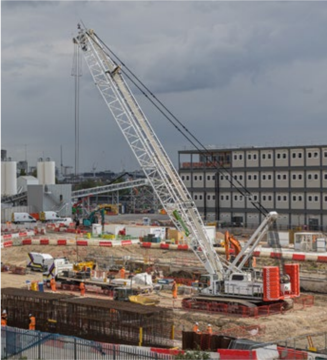
Una gru cingolata a batteria LR 1250.1 unplugged durante operazioni di sollevamento a Londra (Regno Unito)
