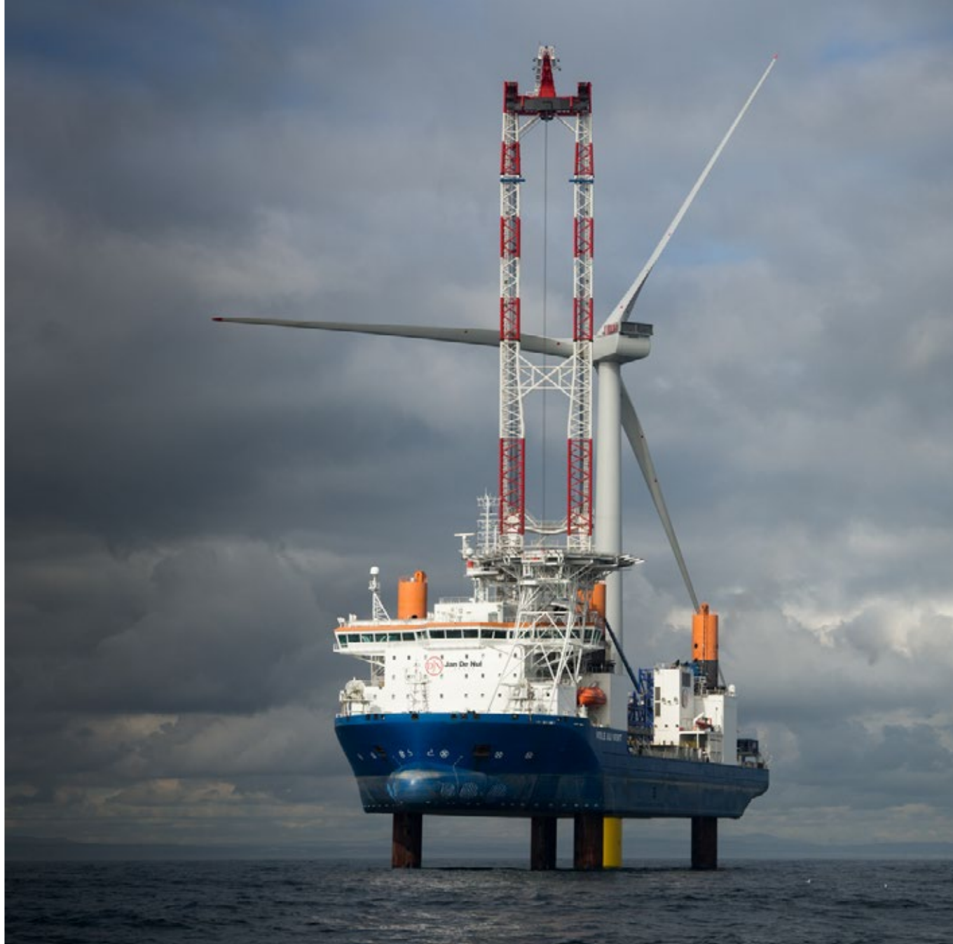
Una gru offshore modello "around the leg" CAL 45000, in azione a bordo di "Vole au Vent", può sollevare fino a 1.200 tonnellate.
