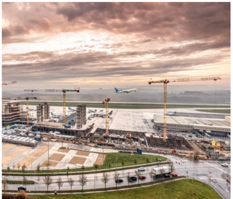
Una gru EC-B durante la costruzione dello Skypark Business Center in Lussemburgo
