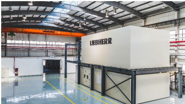
Liebherr-transportation-systems-china-pinghu-climate-chamber-2020.jpg Chambre climatique de Liebherr-Transportation Systems (Chine) Co., Ltd. à Pinghu - © Liebherr
