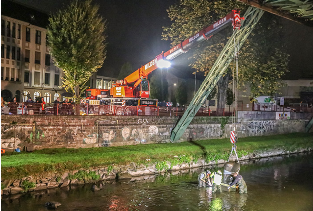
liebherr-ltf1045-4.1-wilden-tuffi4.jpg Zu Hause: Vorsichtig wird Tuffi wieder auf den alten Sockel montiert.
