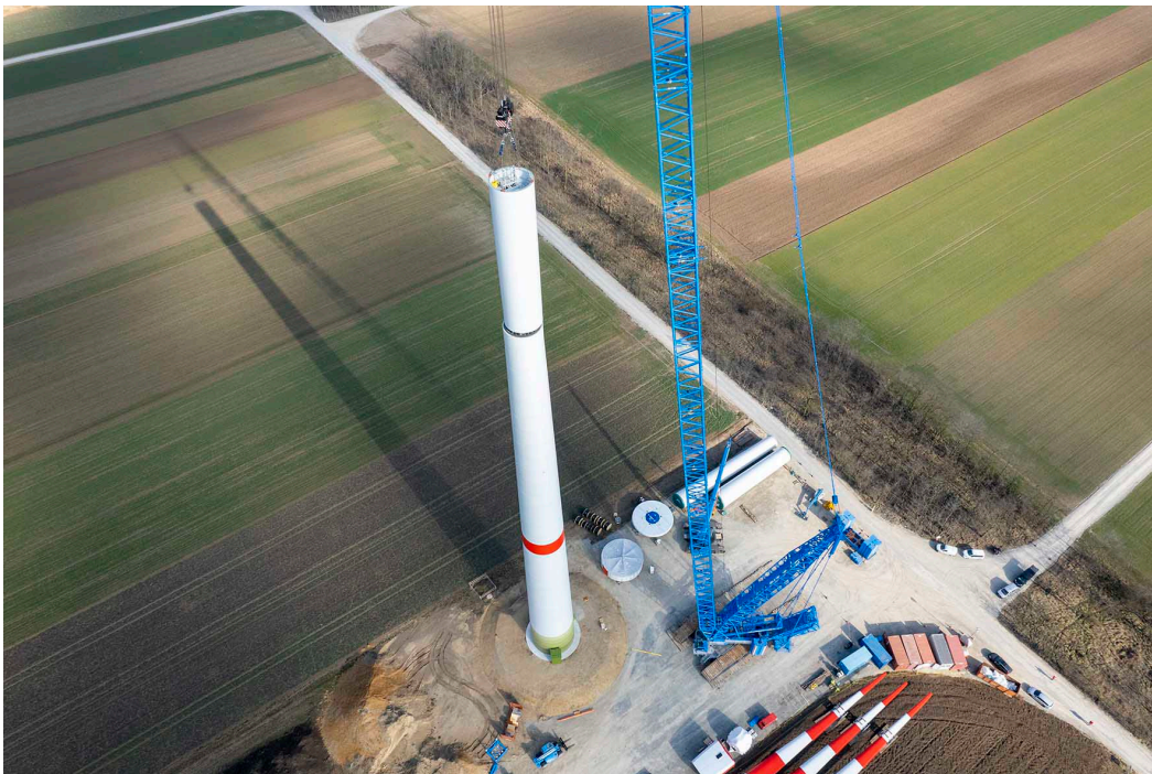
liebherr-lr11000-felbermayr-2.jpg Un encombrement minimal : d'en haut, on constate à quel point la LR 11000 dotée du système V-Frame occupe peu de surface sur le chantier.
