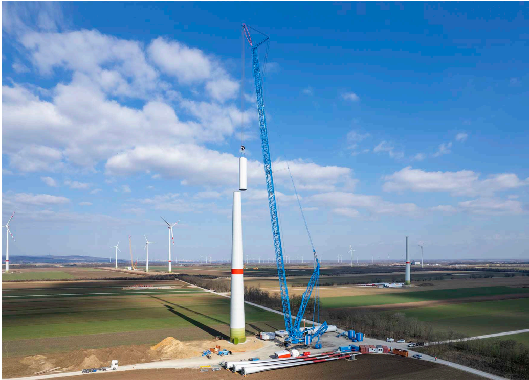
liebherr-lr11000-felbermayr-1.jpg La grue sur chenilles Liebherr LR 11000 monte des éoliennes dans un parc éolien en Autriche.
