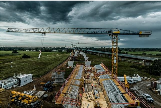
liebherr-125-ec-b-wittenberge-hueffermann-05.jpg Erste Hübe für die neue Brücke. Im Hintergrund ist die parallel verlaufende Bundesstraße 189 zu sehen, die bereits bestehende Brücke soll erhalten bleiben.
