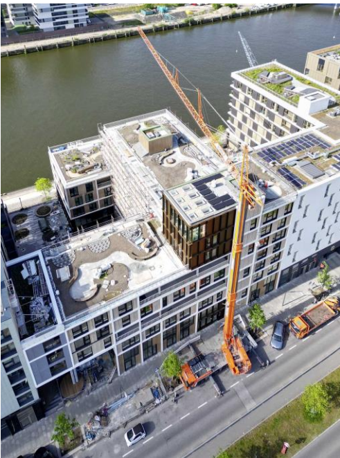
liebherr-mk-140-5.1-schulz.jpg Aufgrund der Vorteile von Mobilbaukränen in der Großstadt – hier der MK 140-5.1 des Unternehmens - bekommt Krandienst Schulz mit einem MK 88 Plus in Kürze seinen fünften Mobilbaukran von Liebherr.
