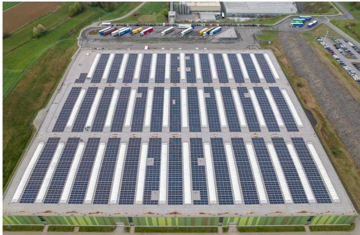
Die neue 2-MW-Photovoltaik-Anlage am Standort Ochsenhausen
