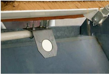
Sensor in Materialrutsche unter Siloauslauf eingebaut
