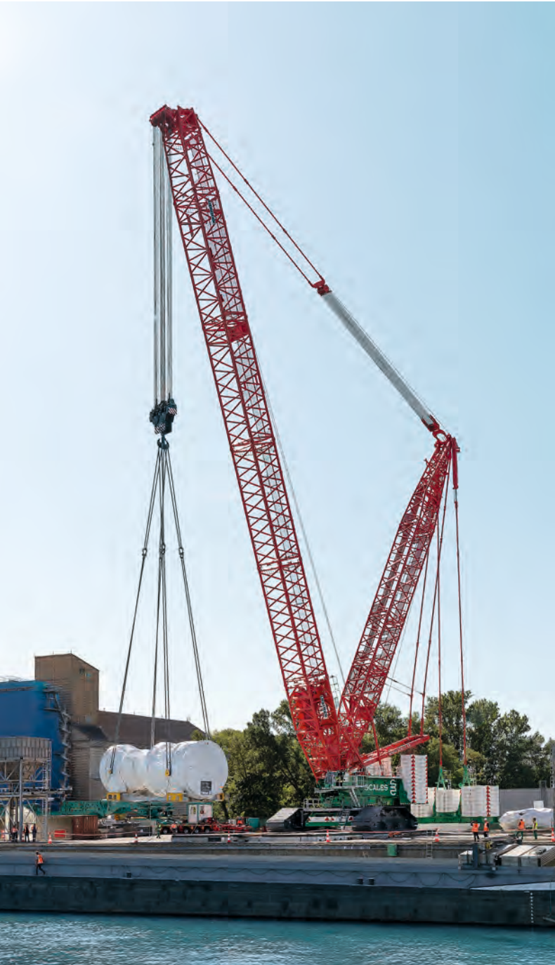
Eine Gasturbine kann bis zu 450 t wiegen – daher wurde der LR 11000 dauerhaft im Hafen installiert.
