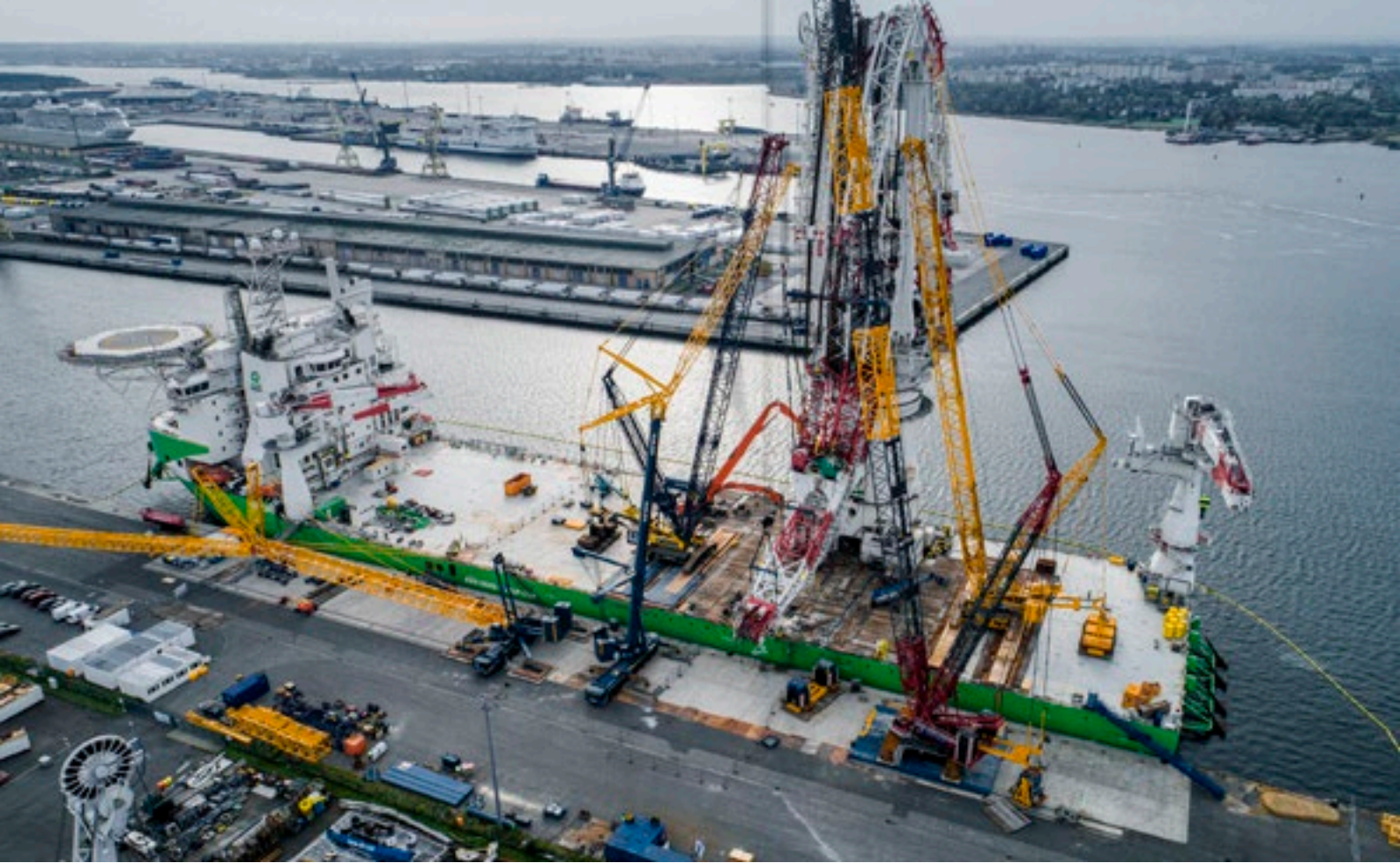
Recuperación y desmantelamiento del HCL 295000 con grúas móviles y sobre orugas de Liebherr.
