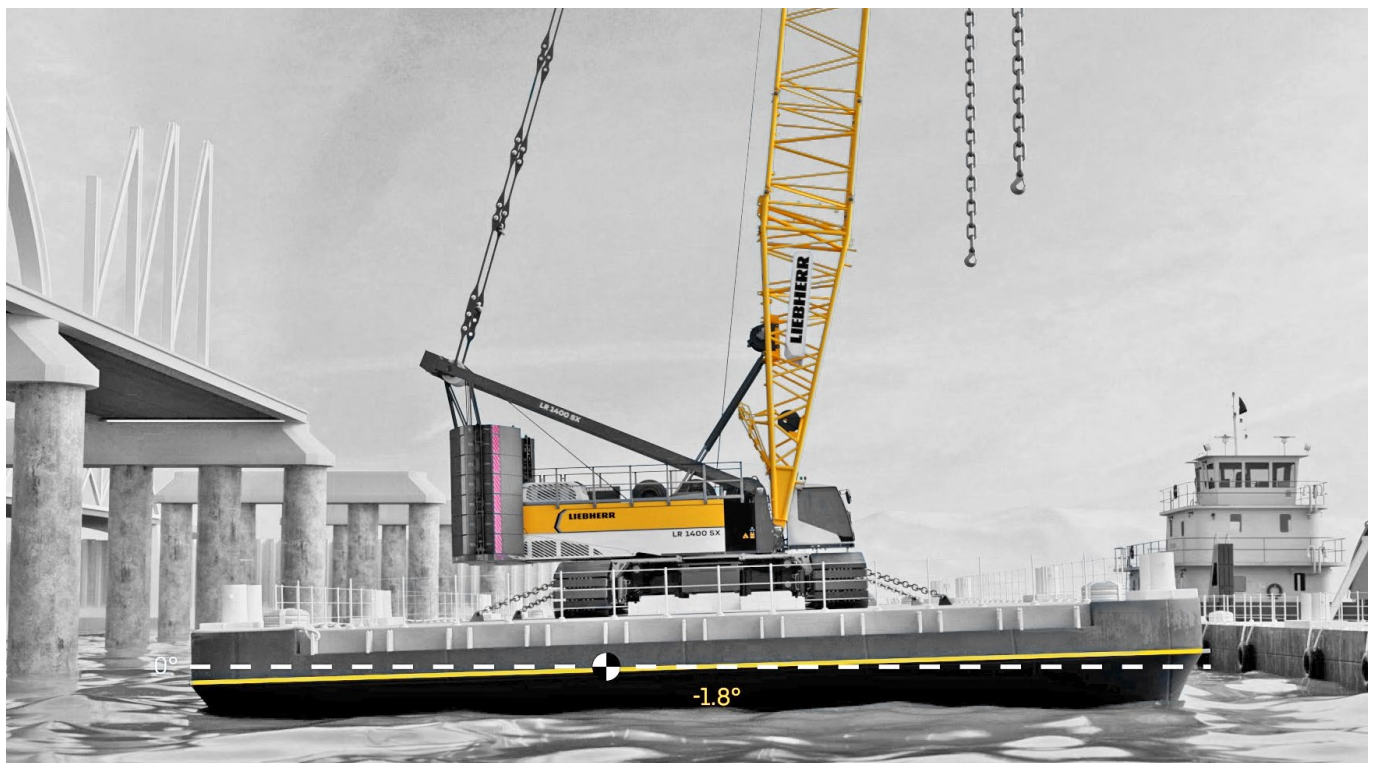
Die Neigung der schwimmenden Konstruktion wird von der Kransteuerung überwacht. Entsprechend wird der Fahrer bei Überschreitung des eingestellten Neigungswinkels gewarnt.
